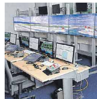
Der Leitstand mit IHSE-Technik am Airport Frankfurt. FOTO: PR
